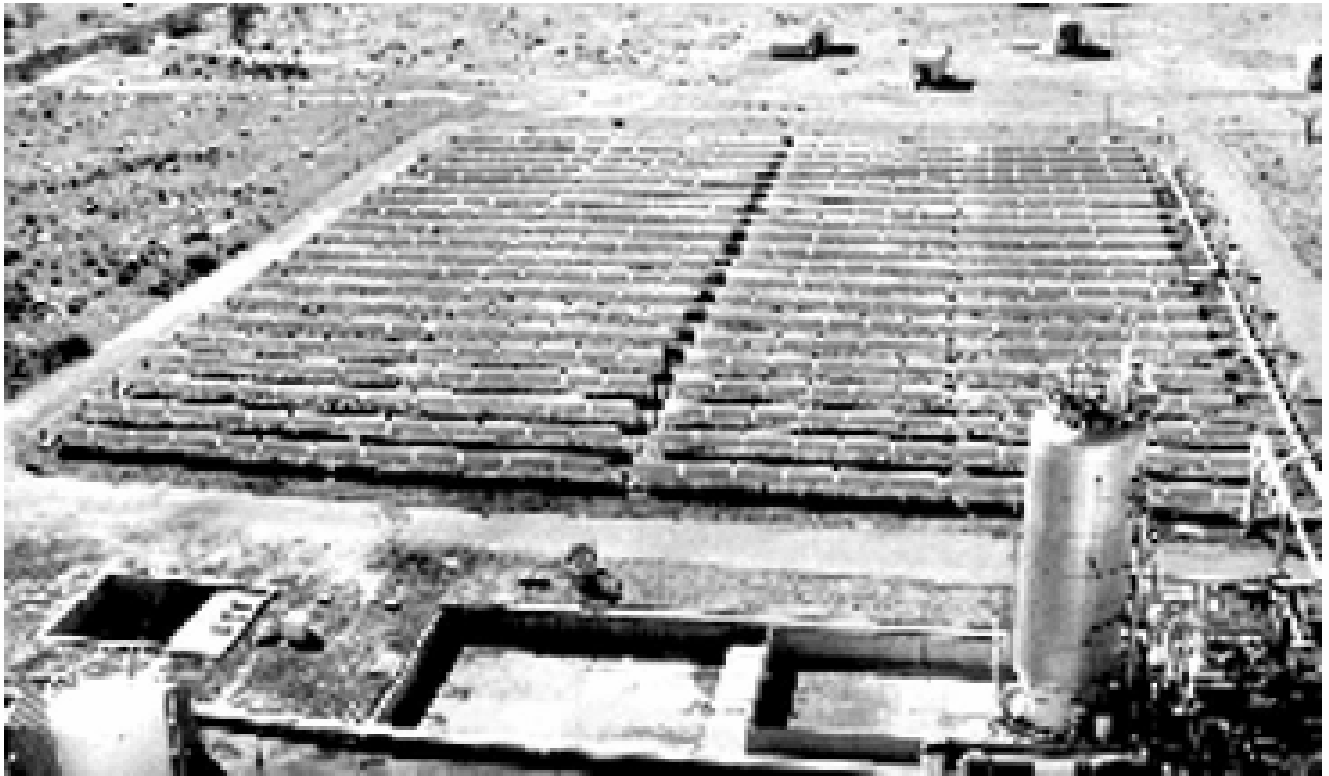
Figura 1. Planta Solar en Almería, España.
